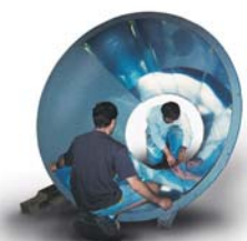
Proyecto Artelio Conducto D=90 cm, L=14 m
